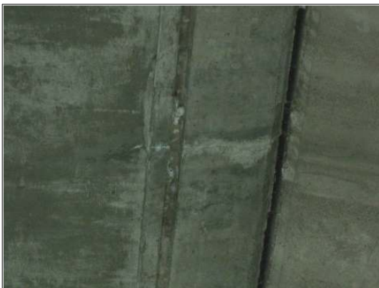
c. S 27 (원주방향) 중분대측 캔틸레버균열 및 백태
