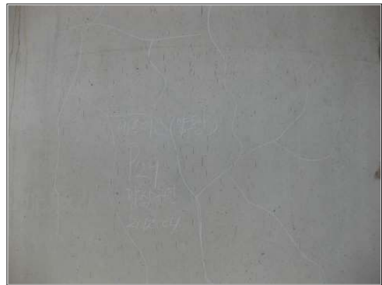
d. P 29 (양평방향) 기둥부 망상균열
