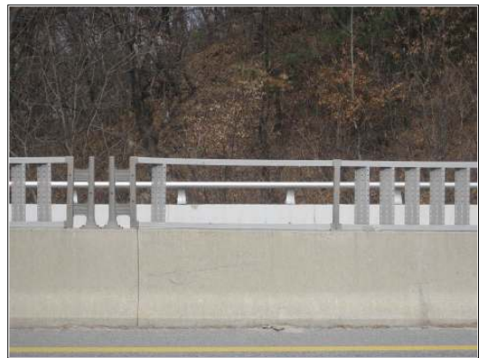
b. S 1 중앙분리대 난간 탈락
