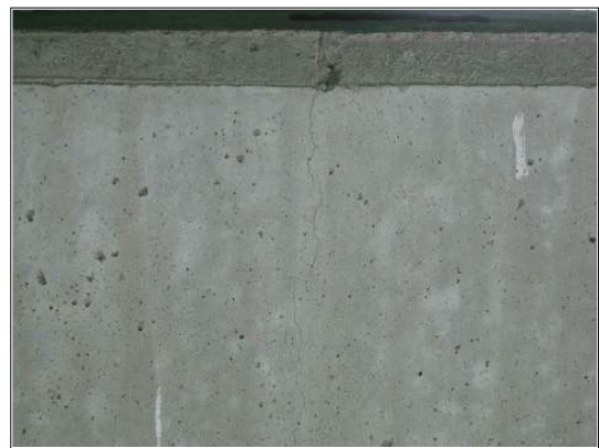
f. P 19 (양평방향) 코핑부 균열
