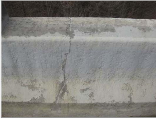
c. S 3 (원주방향) 방호벽 수직균열
