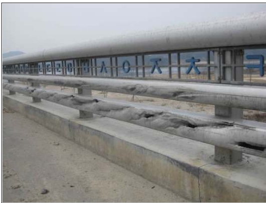
a. S 32 (원주방향) 난간 파손(L=21.0m)
