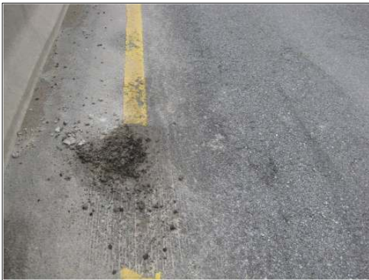
a. S 32 (원주방향) 아스콘 파손
