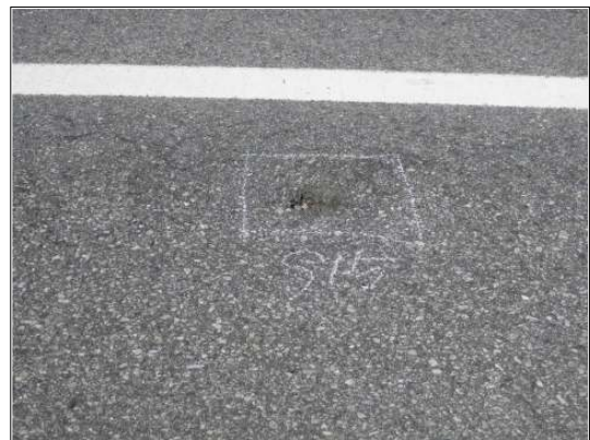
d. S 15 (양평방향) 아스콘 파손
