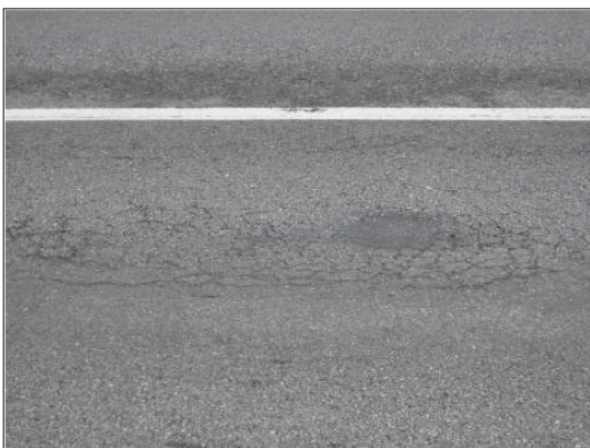
e. S 28 (원주방향) 아스콘 포장 망상균열
