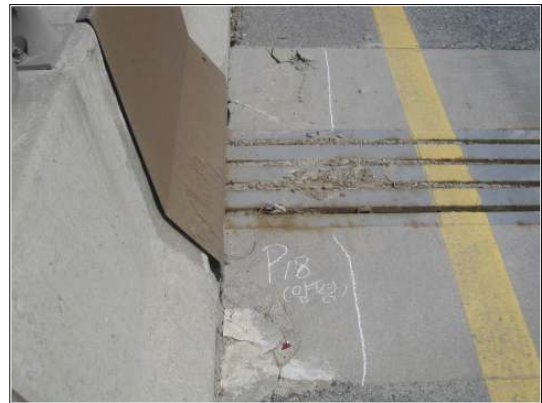
f. P 18 (양평방향) 후타재 파손
