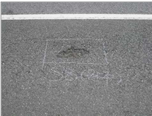
c. S 8 (원주방향) 아스콘 파손
