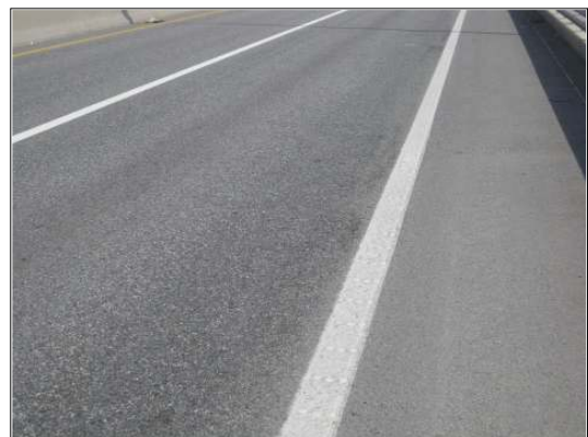
f. S 13 (양평방향) 아스콘 소성변형
