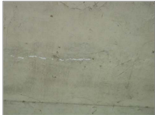
b. S 30 (양평방향) G 1~2 균열 및 백태
