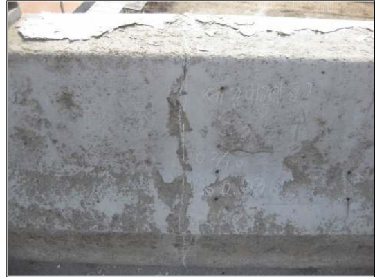
d. S 3 (양평방향) 연석 수직균열
