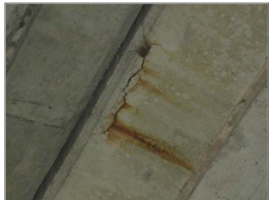
d. S 30 (양평방향) 중분대측 캔틸레버 철근노출
