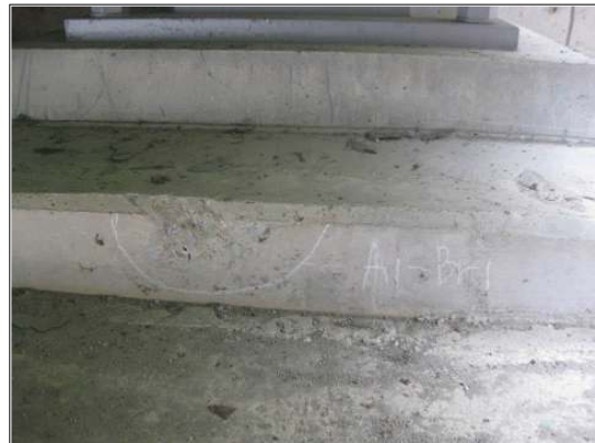
d. A 1 (원주방향) 받침콘크리트 박리
