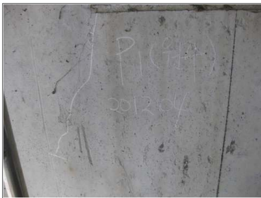
e. P 1 (원주방향) 코핑부 균열
