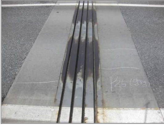
c. P 25 (양평방향) 후타재 균열
