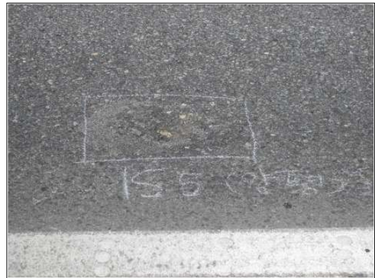
b. S 8 (양평방향) 아스콘 파손
